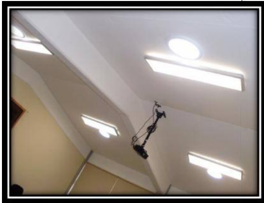
Lámparas instaladas en aulas para mejorar la iluminación
