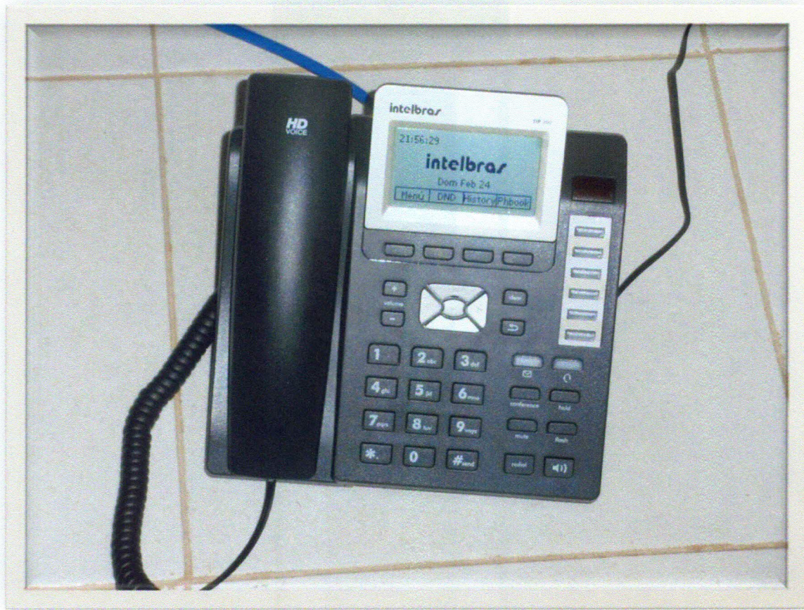
Teléfonos IP marca INTELBRAS MODELO VOIPER
