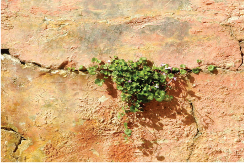
Foto 13. Florecimiento en las grietas del muro
