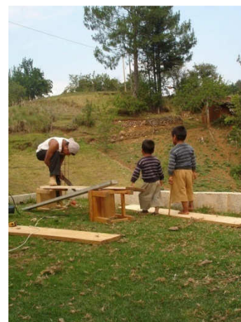
Paco 5 años, y Ciro 4 años, ayudándole a su hermano mayor Nazario, a construir la puerta del baño.
