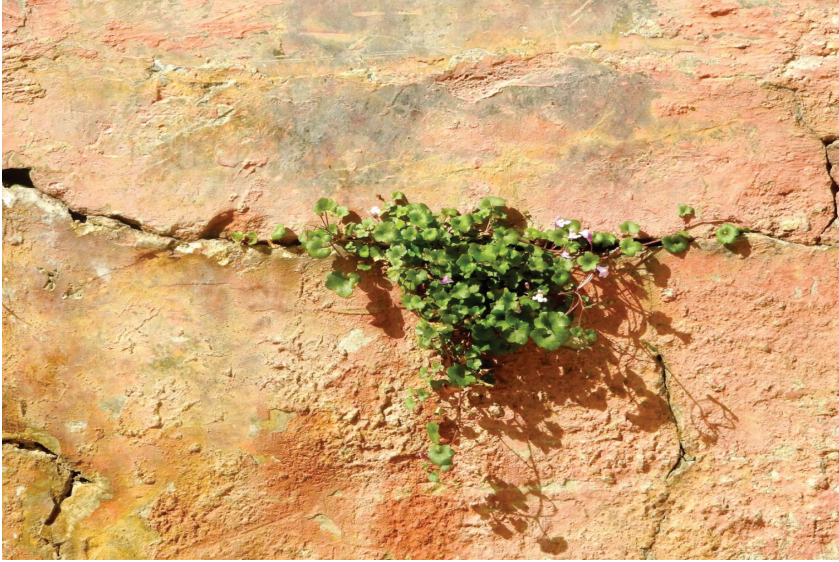
Foto 13. Florecimiento en las grietas del muro
